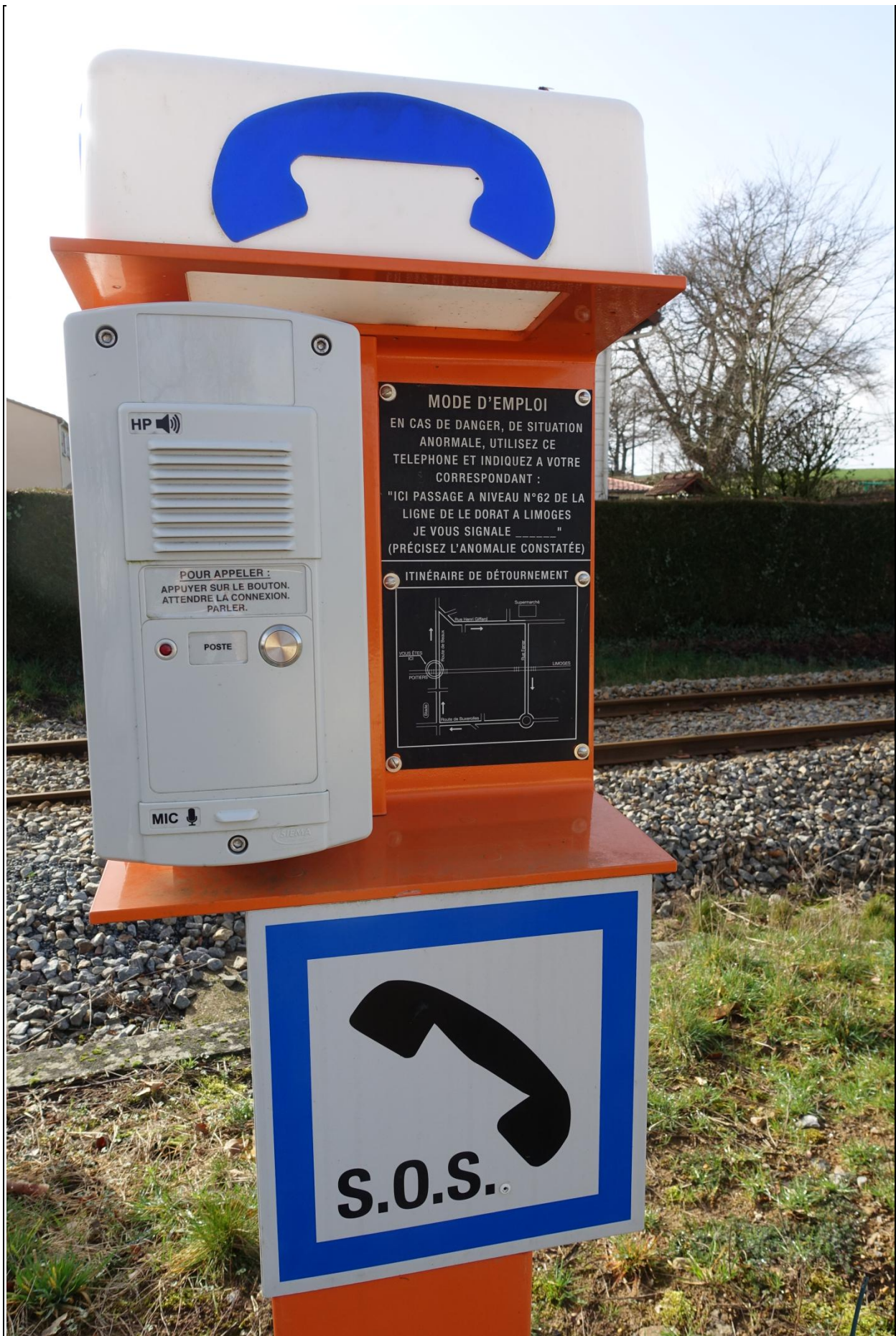
Couzeix, poste pour prévenir les secours le long de la voie Limoges - Le Dorat.
