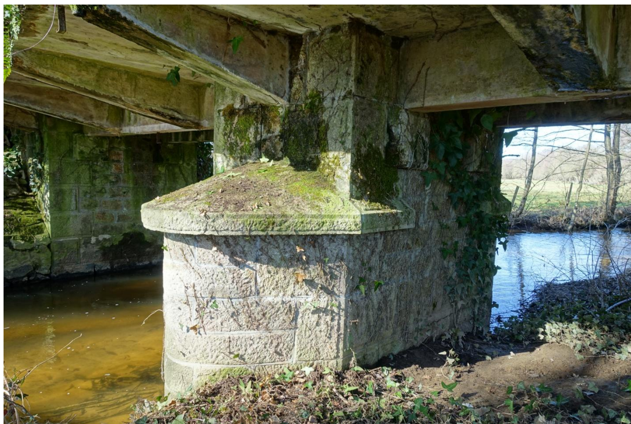
Beaune-les-Mines, Grossereix, le pilier central de l'ancien pont. Etat au 12 février 2019.
