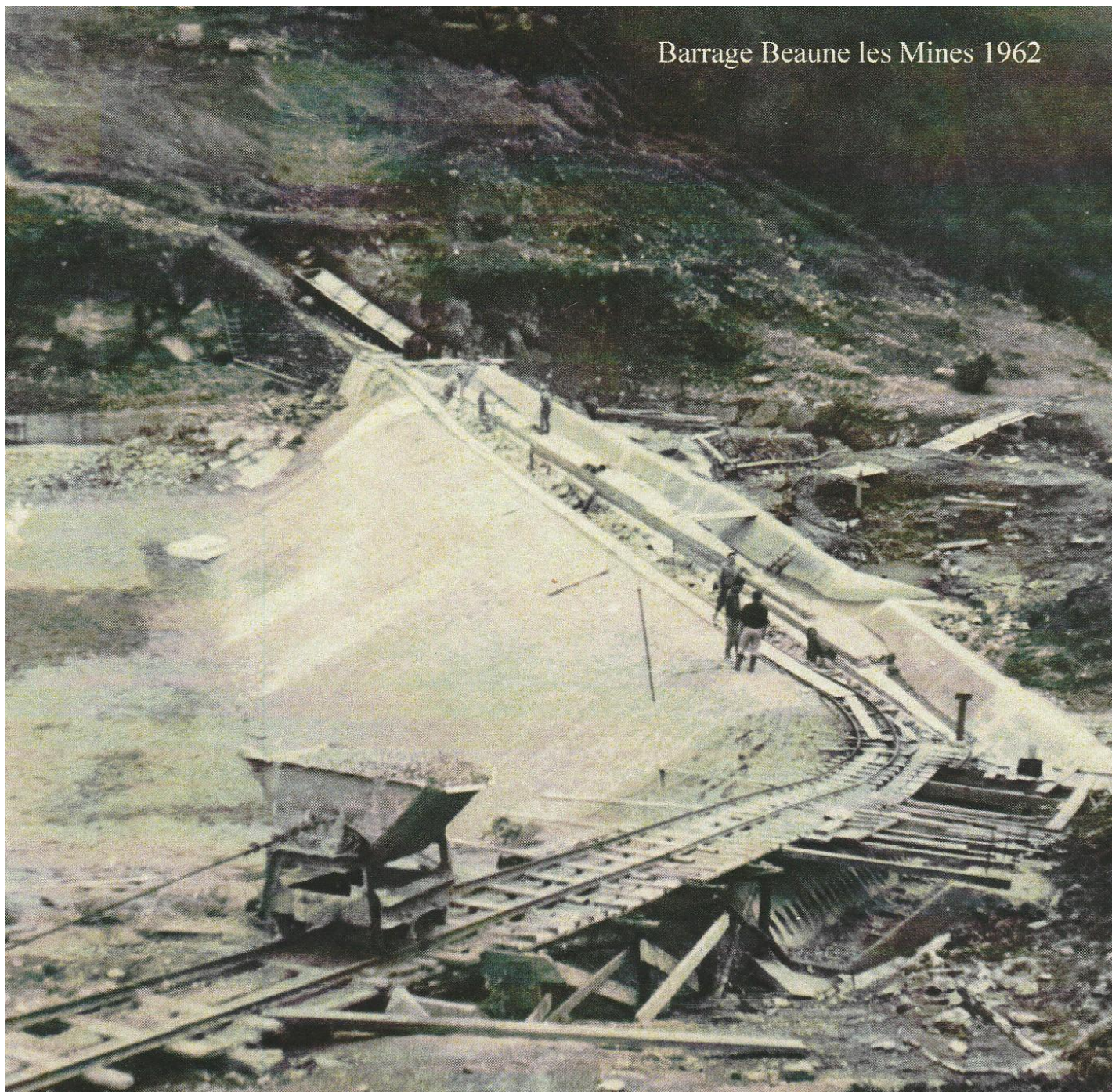
La construction du barrage de la retenue de Beaune 2 en 1962. Collection privée.
